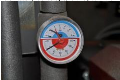
Potrubí by mělo být důsledně odizolováno
