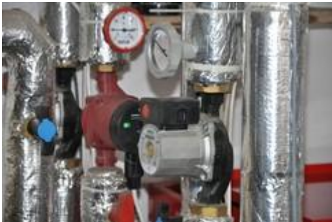
Důležité je precizní provedení kotelen
